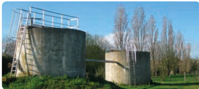
Station de traitement des eaux usées d'Assais-les-Jumeaux à lit bactérien
